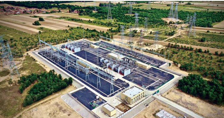
▲ 巨宝庄 500 千伏变电站
